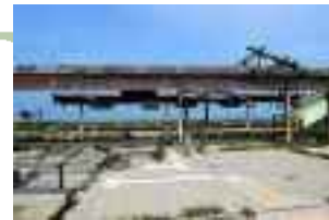
津波で被災した富岡駅「震災の記録」
